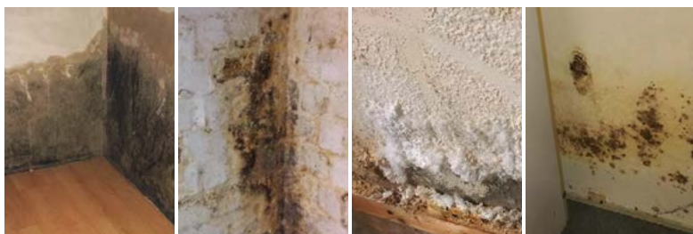
Defekte Horizontalsperre Querdurchfeuchtung Ausblühungen Schimmelbefall
