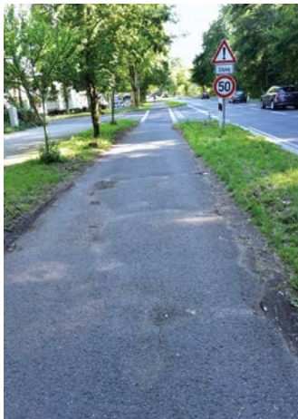
Rodenkirchen, sehr schadhafter Rad-/Fuß in der Industriestraße, hier Höhe Zufahrt zur Reitanlage.
