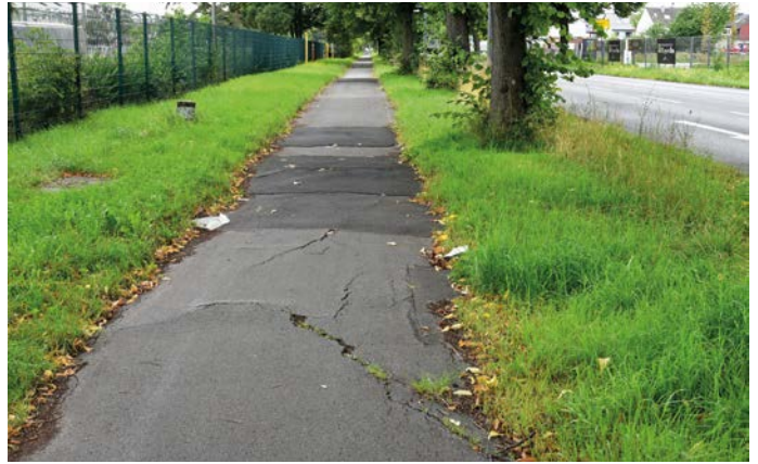
Godorfer Hauptstraße, Sanierung Rad-/Fußweg in Planung. Alle Fotos: E. Broich.
