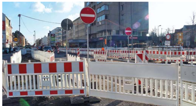
Verloren im Barken-Meer: Fußgänger in den Baustellenbereichen entlang der Bonner Straße wissen oft nicht, wo sie entlang sollen, wie hier an der Kreuzung Bonner Straße/Schönhauser Straße/Marktstraße.
