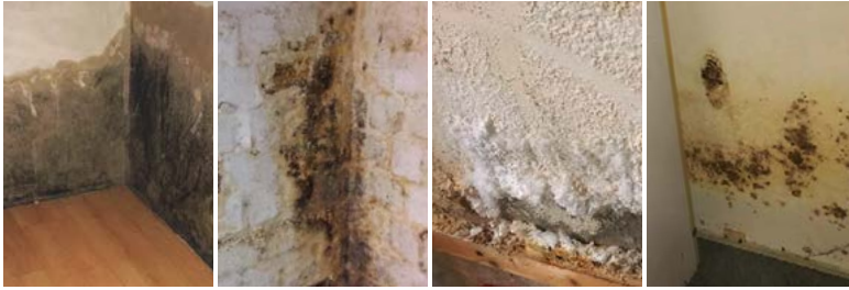
Defekte Horizontalsperre Querdurchfeuchtung Ausblühungen Schimmelbefall
